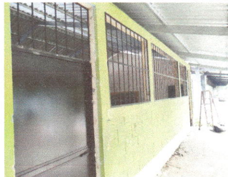
FOTO 4: Sustrucción de balcones a metal
